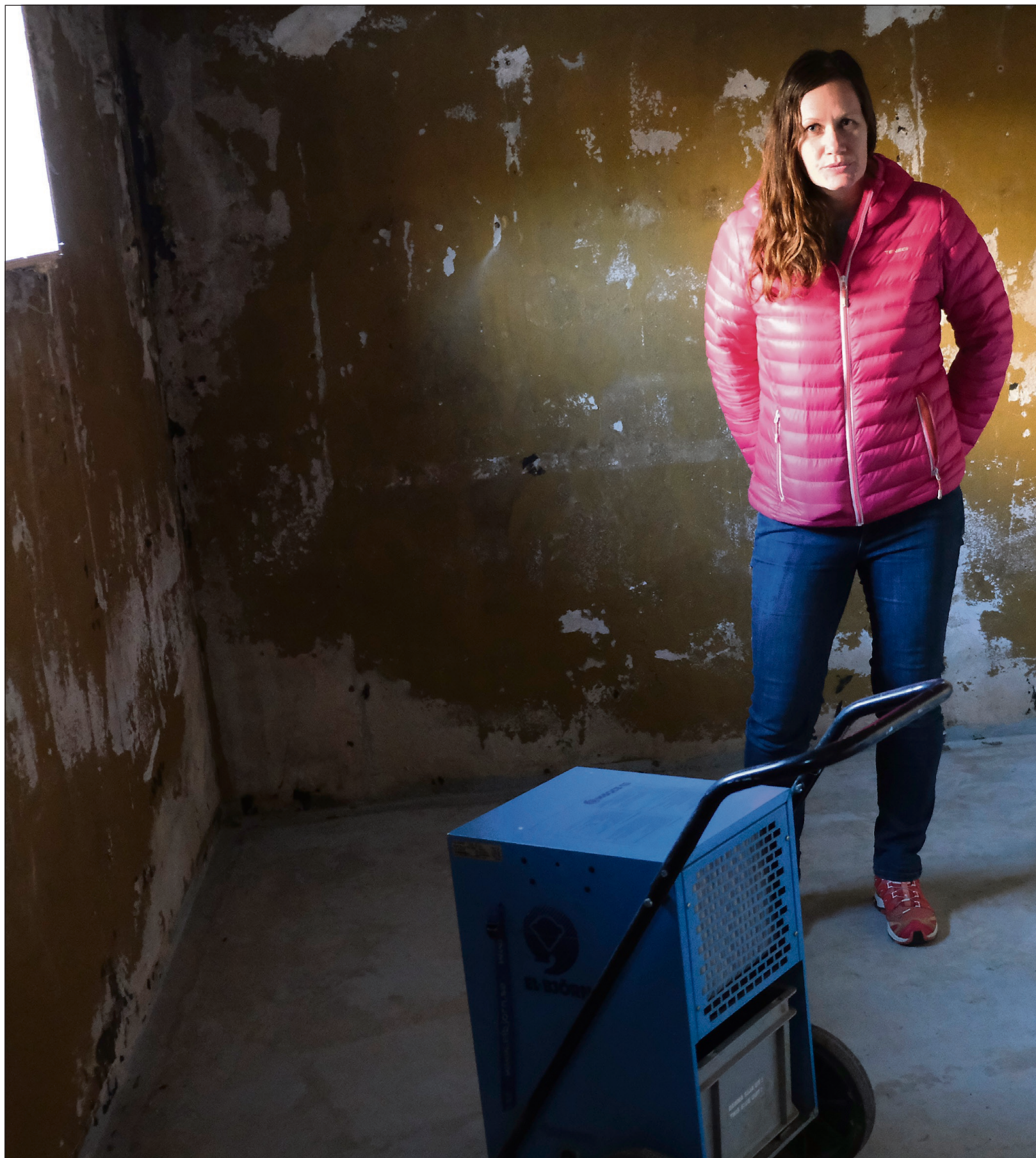
MÅTTE RIVE ALT: Alt i kjelleren måtte rives på grunn av fuktskader, opplyser Nina Evensen Reed. Nå står en avfukter på hele døgnet.
